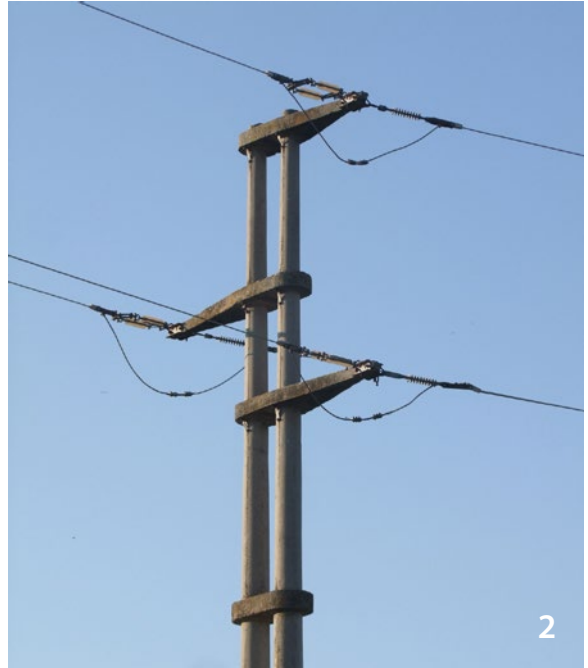
2 Abspannmasten mit horizontalen Isolatorenkette 35 kV (Berovci ID170) – Totfund Weißstorch C. ciconia – 2 Strain pole with horizontal strain insulator string and ventral jumper 35 kV (Berovci ID170) – found dead White stork C. ciconia
