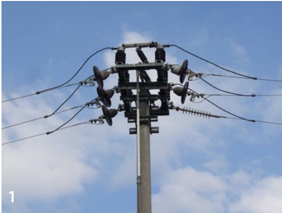
1 Schaltermasten mit isolierter Überbrückung zur Schalterebene und horizontalen Isolatorenketten aus Keramik und Komposit 10-20 kV (Gneotino ID395) – Totfund Weißstorch C. ciconia – 1 Switch pole with insulated dorsal jumper cable to the switch level and horizontal ceramic insulators and composite insulator string, 10-20 kV (Gneotino ID395) – found dead White Stork C. ciconia
