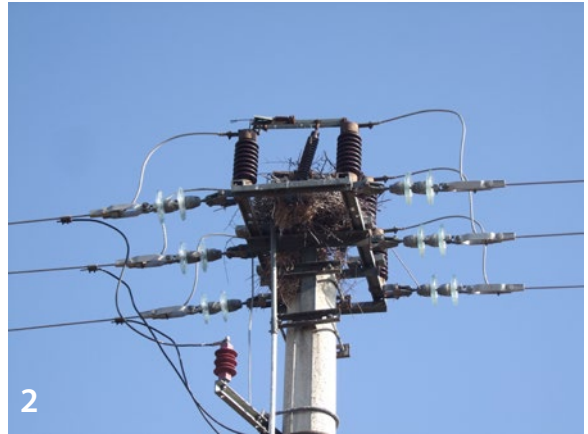
2 Schaltermasten mit nicht isolierten Überbrückung zur Schalterebene und horizontalen Isolatorenketten aus Glas (Krivogashtani ID499) – Totfund Rötelfalke F. naumanni (Nest der Nebelkrähe C.c.cornix mit Nest des Weidensperings P. hispaniolensis ) – 2 Switch pole with uninsulated jumper cable to the switch level and horizontal glass insulator strings (Krivogashtani ID499) – found dead Lesser kestrel F. naumanni (nest of Hooded crow C. c. cornix with nest of Willow sparrow P. hispaniolensis )
