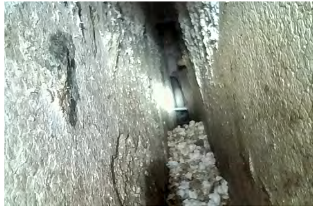
Abb. 3 Bruthöhle in Fassadendämmung. Zwischen der Hauswand (links) und dem Putz (rechts) haben Sittiche das Styropor auf einer Länge von 1,80 m und einer Höhe von gut 30 cm vollständig entfernt.
